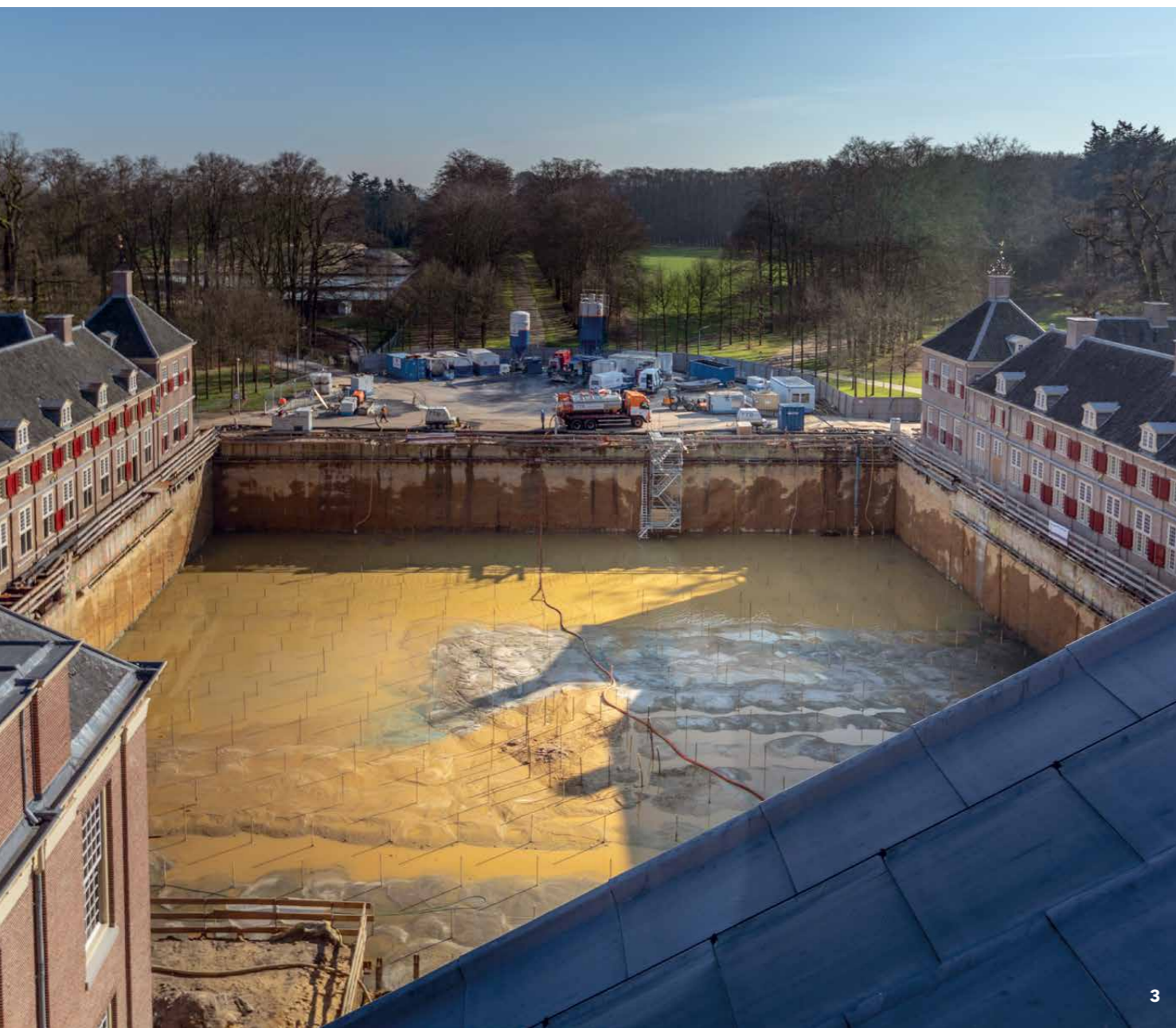
1 De Bassecour kwam op een gegeven moment geheel onder water te staan. Een reddingsboei was daarom verplicht. 2 De betonvloer van de ondergrondse uitbreiding wordt door duikers onder water gestort. 3 De contouren van de uitbreiding van Paleis Het Loo worden zichtbaar.
